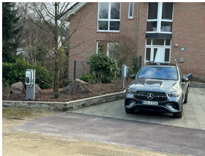
Auf dem Bild zu sehen: zwei von insgesamt 16 Ladepunkten auf dem Gelände, verteilt auf vier Gebäude
